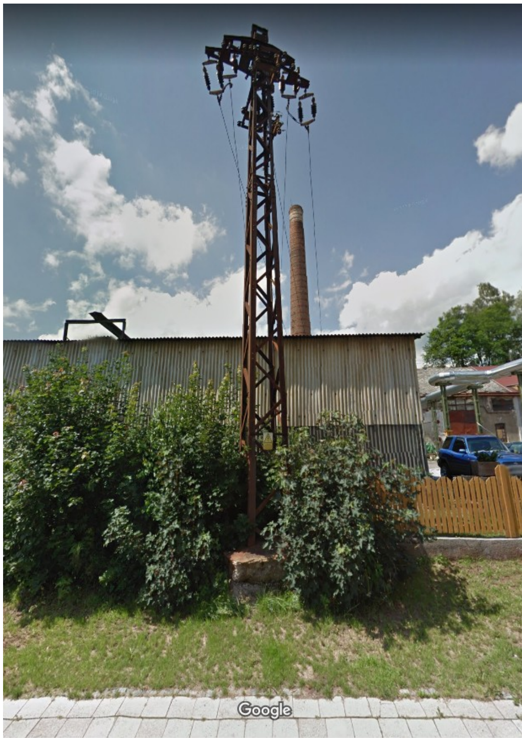
Obrázek 31: Pohled na stožár z ulice s detailem zavěšení vodičů 35kV
